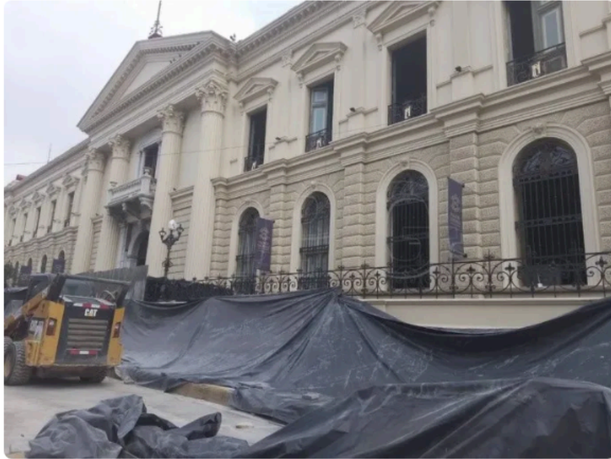
Así continúan este domingo los trabajos de remoción de piso en el Palacio Nacional. Foto José Cardona
