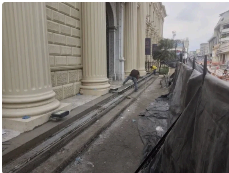
Así continúan este domingo los trabajos de remoción de piso en el Palacio Nacional. Foto José Cardona
