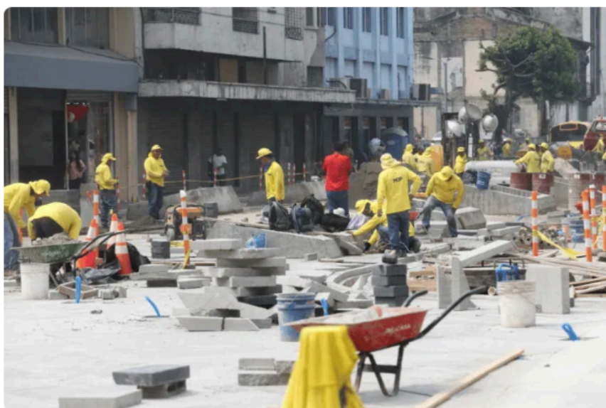
El paso peatonal se ha visto restringido en los alrededores del Palacio Nacional, mientras se realizan varias obras como retirar las aceras con piocha y se cambia el suelo en la calle principal. Foto: Julio Umaña.
