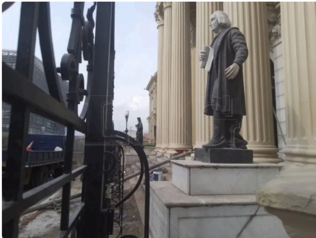
Así continúan este domingo los trabajos de remoción de piso en el Palacio Nacional. Foto José Cardona
