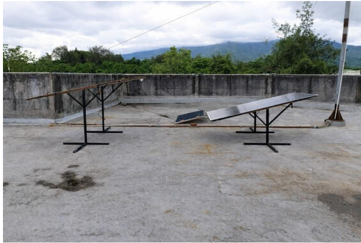
Ilustración 28 Paneles instalados en la biblioteca de la FIA para la investigación
