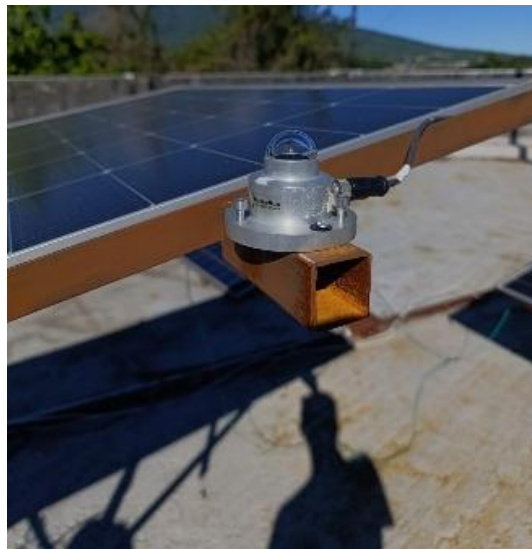
Ilustración 44 Detalle del piranómetro LP02 instalado
