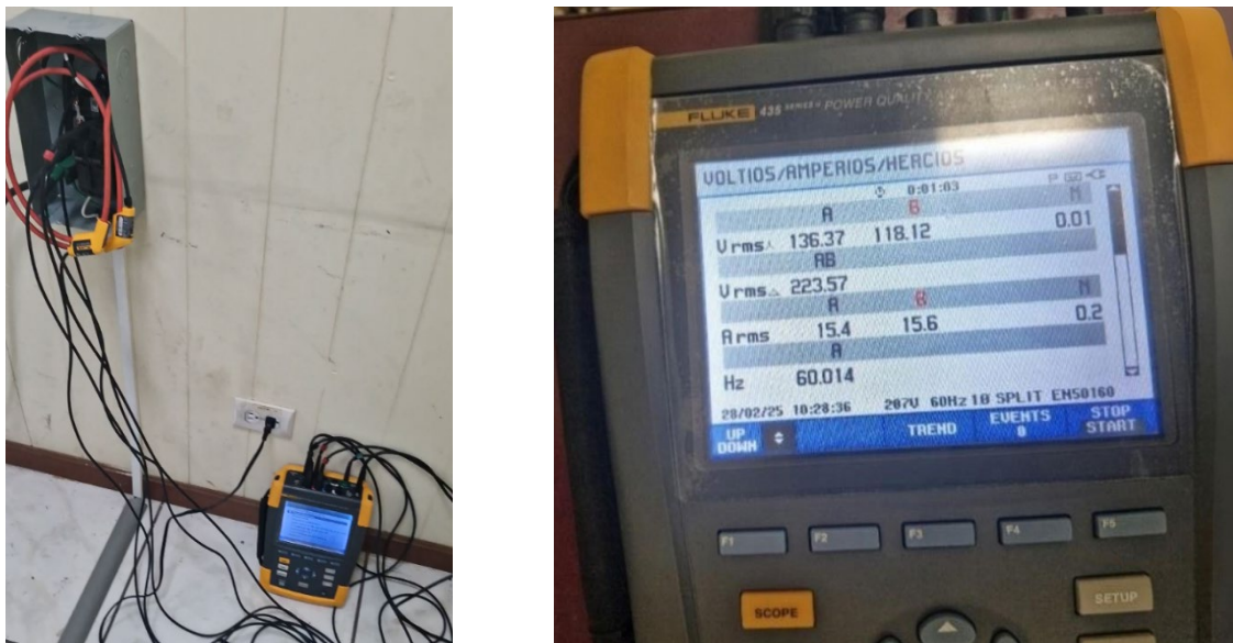
Figura 3-3. (a) Conexión del Fluke 435 al sistema eléctrico del ASIC. (b) Vista de las mediciones registradas
