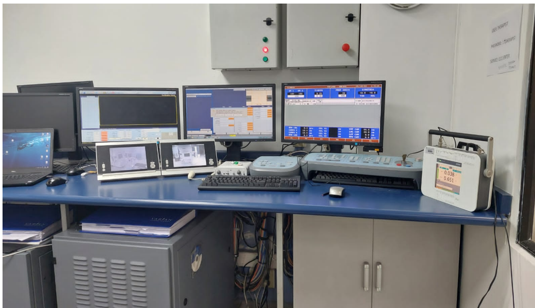
Centro de control.
