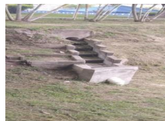
Fotografía n°7: Cabezal de descarga, tomada de visita de campo.
