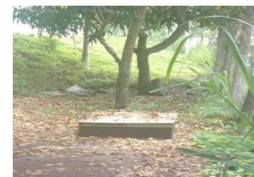
Fotografía n°8: Cisterna recolectora de aguas lluvias, tomada de visita de campo.
