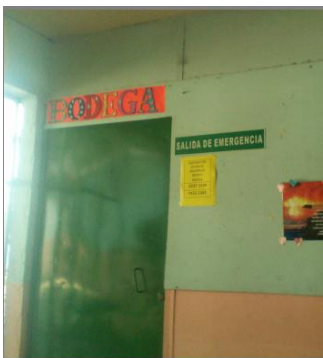
Salida de emergencia con doble señalización
