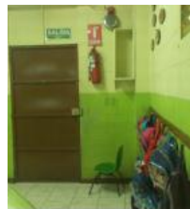
Extintor a una altura de difícil acceso fuera de su ubicación establecida.
