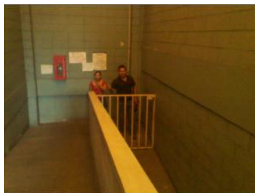
Requerimiento de barandas en rampa.
