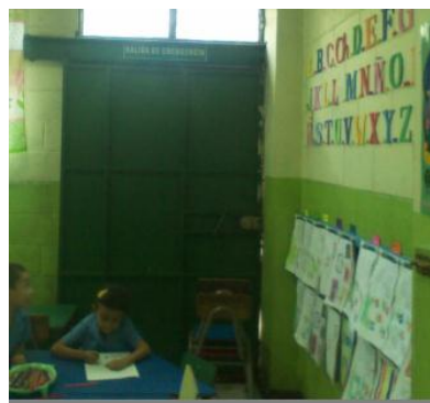
Salida de emergencia obstruida por pupitres ubicada en un salón educativo
