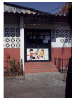
Necesidad de barandas en el acceso a las instalaciones.
