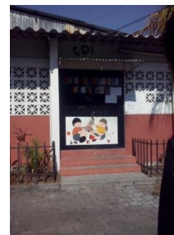
Difícil acceso a beneficiarios con limitación física, debido a la falta de rampas y barandas.
