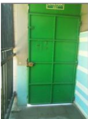
Salida de emergencia de difícil acceso y corredor angosto, con abertura de 90° grados.
