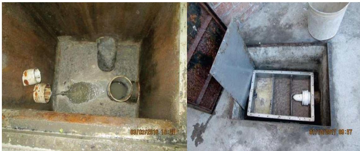
Figura 1.3. Trampas de grasa del área de alimentación, dietas y comedor privado. Fuente: (Instituto Salvadoreño del Seguro Social)
