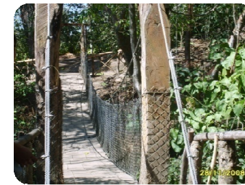
PUENTE COLGANTE EN MALAS CONDICIONES.
