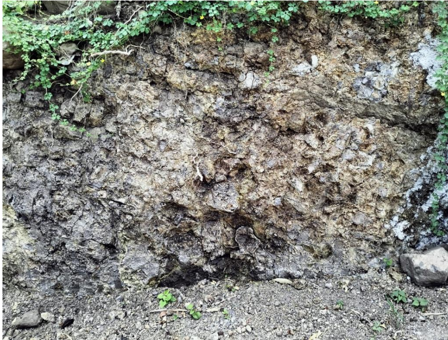
Figura 24. Humedad en pared frente a la propiedad.
