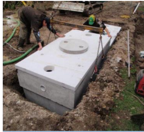
IMAGEN # 60: Sistema de fosa séptica y aguas negras.
