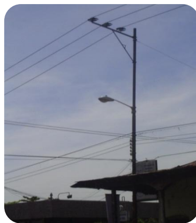
FOTO No 36: Postes de alumbrado eléctrico. FUENTE: Visita de campo del grupo de trabajo
