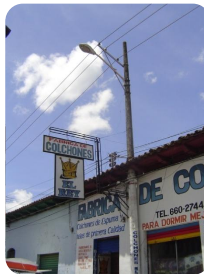
FOTO No 45: Alumbrado eléctrico. FUENTE: Visita de campo del grupo de trabajo
