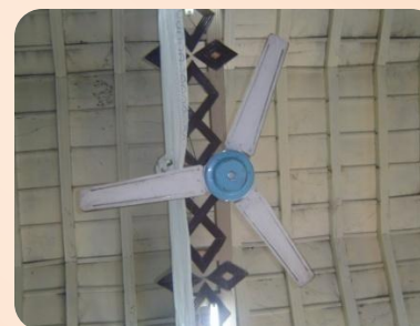
Ventilador de techo
