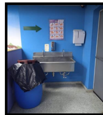
Ilustración 445. Iluminación en Estación de lavado de manos
