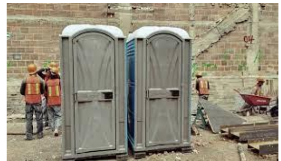
Imagen 8. Sanitarios portátiles para trabajadores
