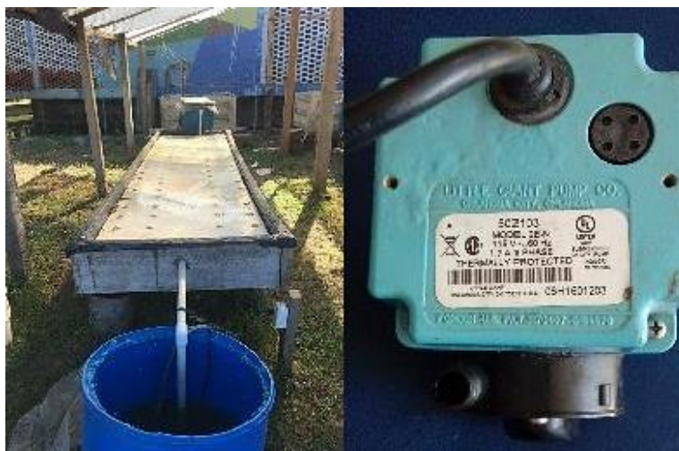
Figura 11. Barril receptor y bomba sumergible.
