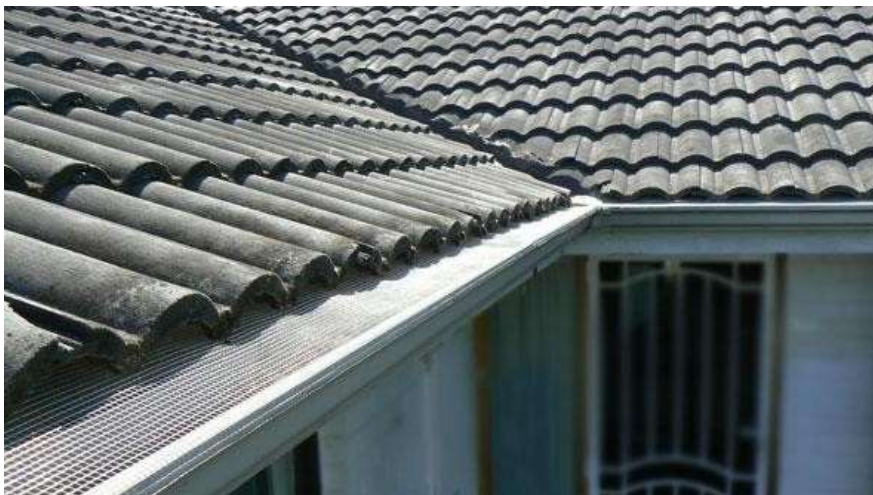
Ilustración 5 Sistema de conducción instalado por medio de canaletas
