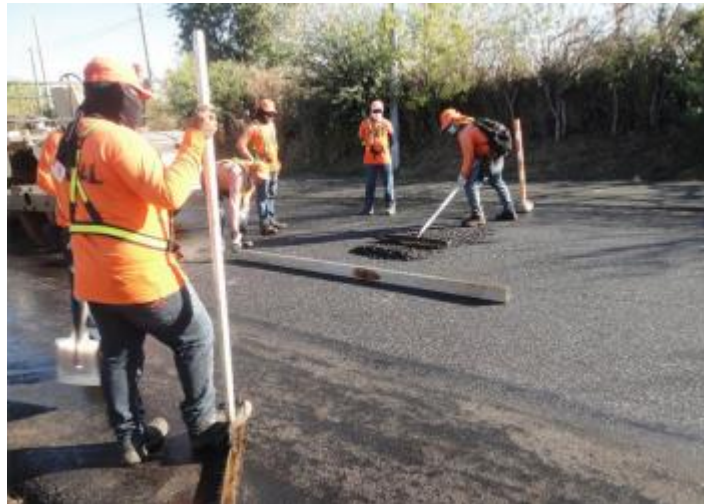
Ilustración 2.3-17: Perfilado final a mano, 02 de febrero de 2022. Fuente: Tesis (2022) Manual del proceso constructivo para la colocación de carpeta asfáltica, utilizando la técnica de reciclado en caliente in situ, para mejorar el desempeño del pavimento existente en la carretera CA08W, en el tramo desde Ahuachapán Centro, a partir del desvío de Ataco hasta la frontera Las Chinamas, dpto. de Ahuachapán.
