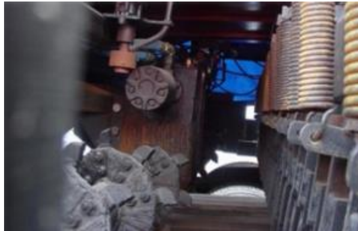
Ilustración 2.3-14: Sistema de Inyección de Agente Rejuvenecedor, Est 9+000. Fuente: Tesis (2022) Manual del proceso constructivo para la colocación de carpeta asfáltica, utilizando la técnica de reciclado en caliente in situ, para mejorar el desempeño del pavimento existente en la carretera CA08W, en el tramo desde Ahuachapán Centro, a partir del desvío de Ataco hasta la frontera Las Chinamas, dpto. de Ahuachapán.
