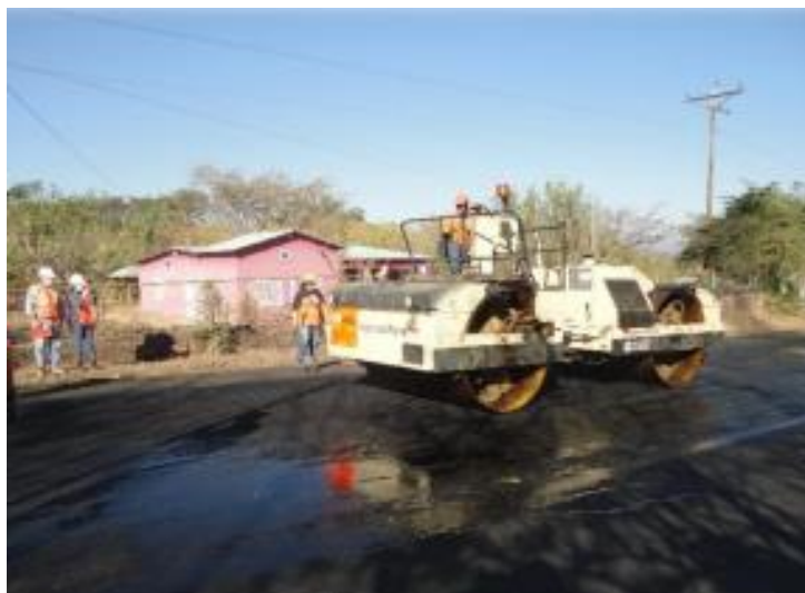
Ilustración 2.3-18: Compactación con Rodo Vibratorio. Fuente: Tesis (2022) Manual del proceso constructivo para la colocación de carpeta asfáltica, utilizando la técnica de reciclado en caliente in situ, para mejorar el desempeño del pavimento existente en la carretera CA08W, en el tramo desde Ahuachapán Centro, a partir del desvío de Ataco hasta la frontera Las Chinamas, dpto. de Ahuachapán.
