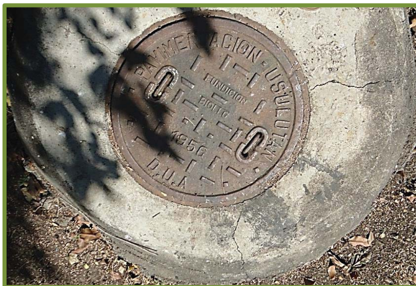
FOTOGRAFIA 4.1.3.1: POZO DE VISITA CON TAPADERA QUE NO PERTENECE A LA CIUDAD
