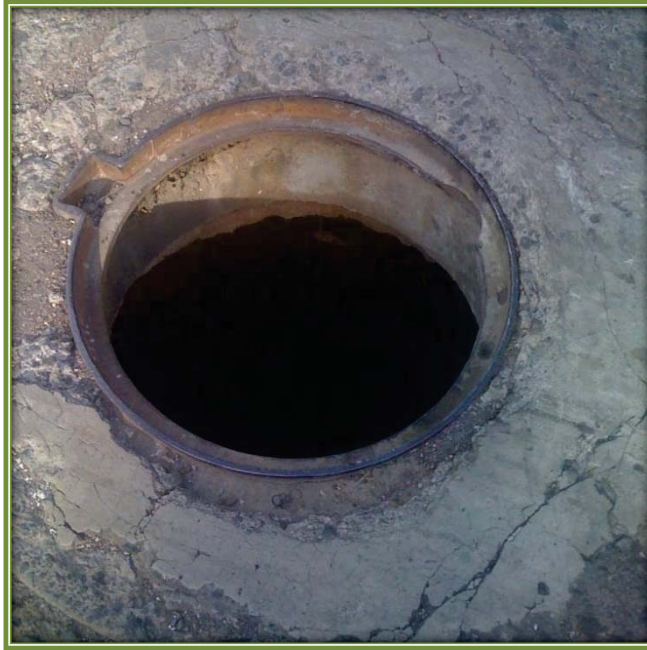
FOTOGRAFIA 4.1.3.3: POZO DE VISITA SIN SU RESPECTIVA TAPADERA
