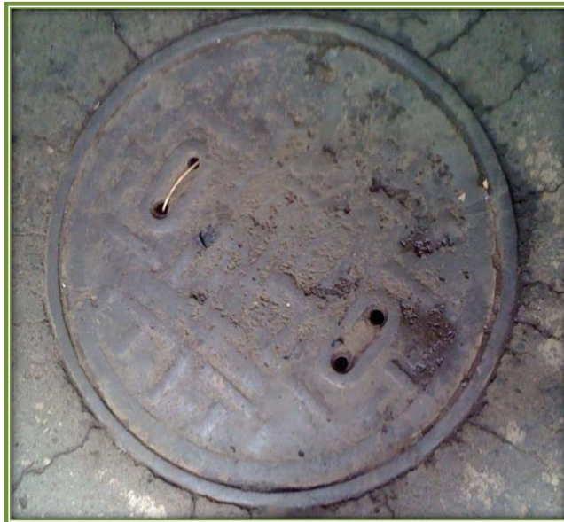
FOTOGRAFIA 4.1.3.4: POZOS DE VISITA CON TAPADERA SIN INSCRIPCION
