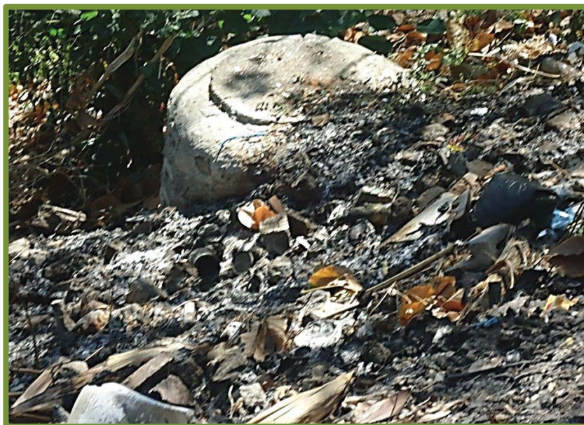
FOTOGRAFIA 4.1.3.2: POZO DE VISITA SOTERRADO DE BASURA Y RIPIO
