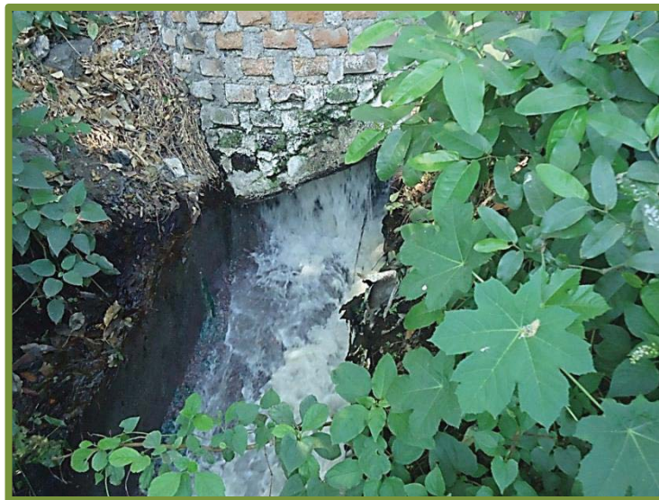
FOTOGRAFIA 4.1.3.5: POZOS DE VISITA EN LOS PUNTOS DE DESCARGA
