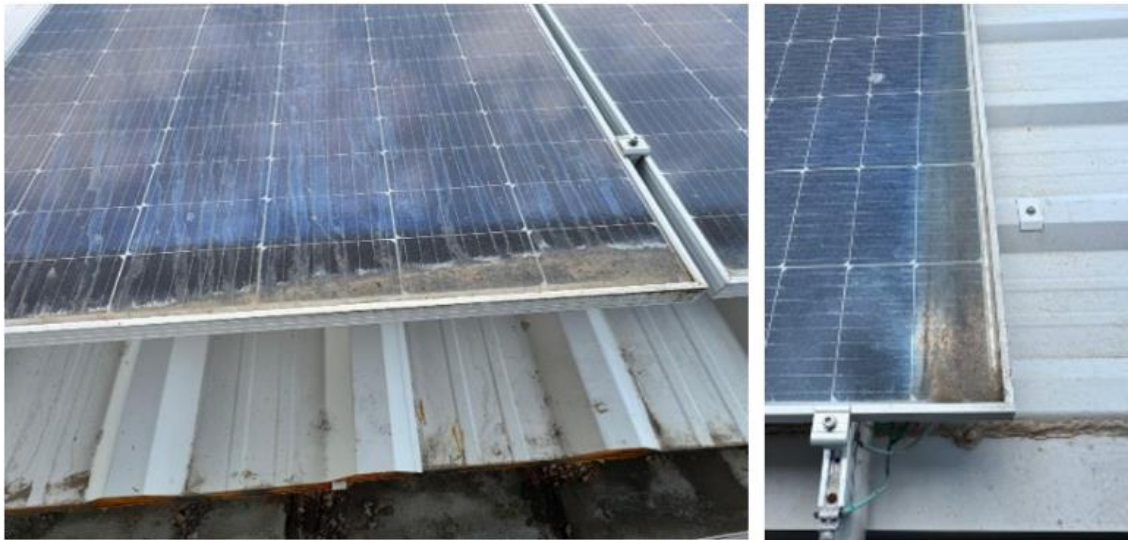
Figura 45 Paneles en mal estado. Nota: Fotografía capturada por el autor (2025).
