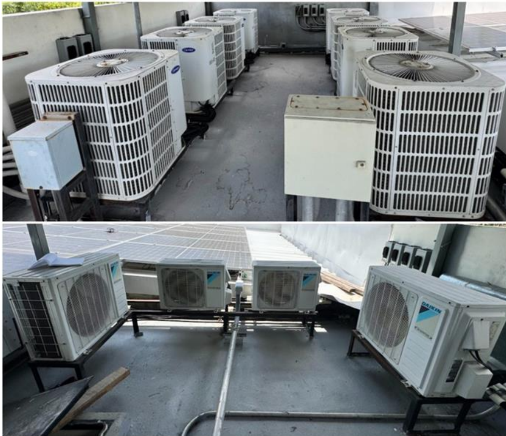
Figura 43 Unidad Condensadora de Equipos de AA. Nota: Fotografía capturada por el autor (2025).
