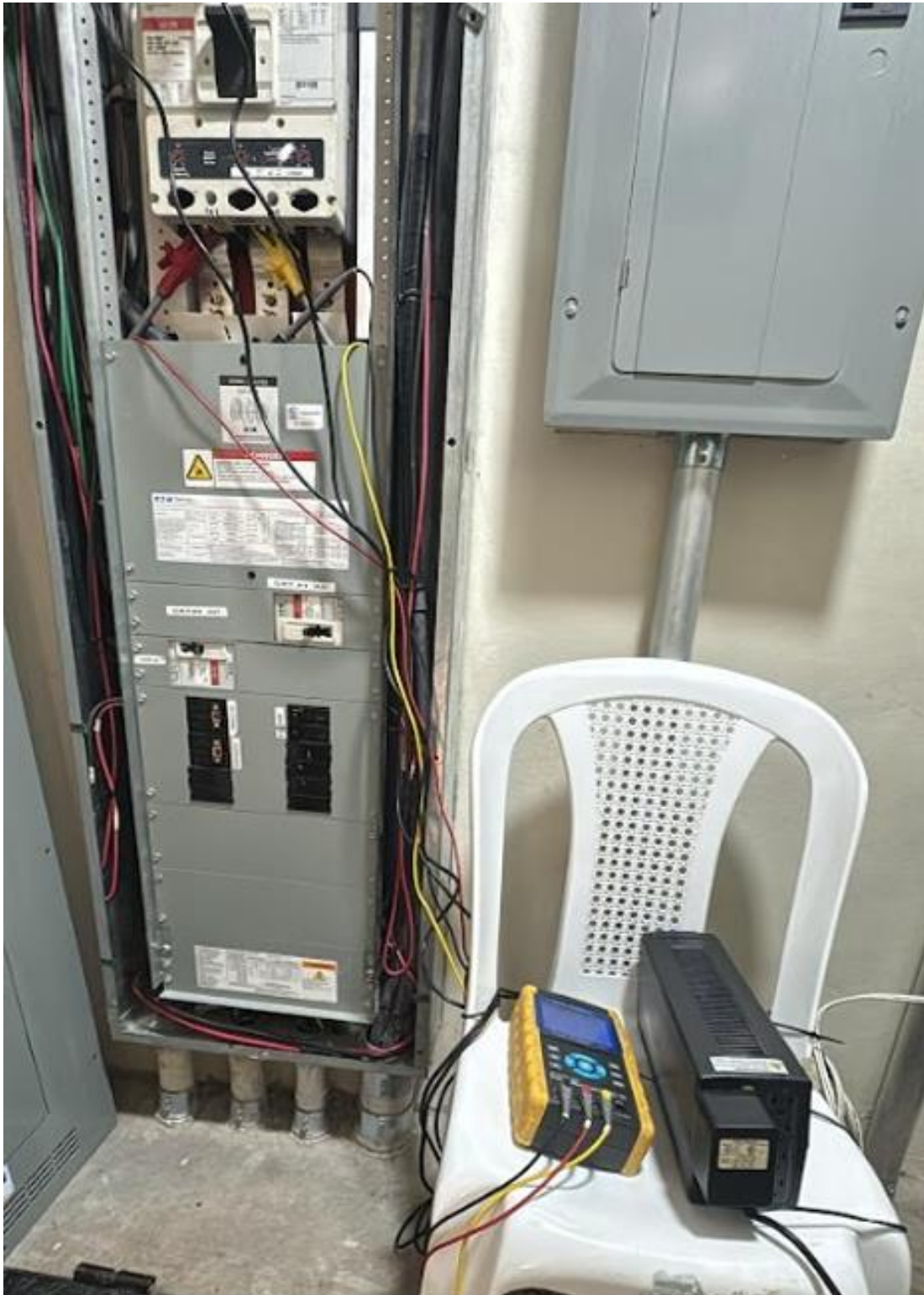
Figura 29 Analizador de potencia PCE-PA 8000 conectado al tablero principal. Nota: Fotografía capturada por el autor (2025).
