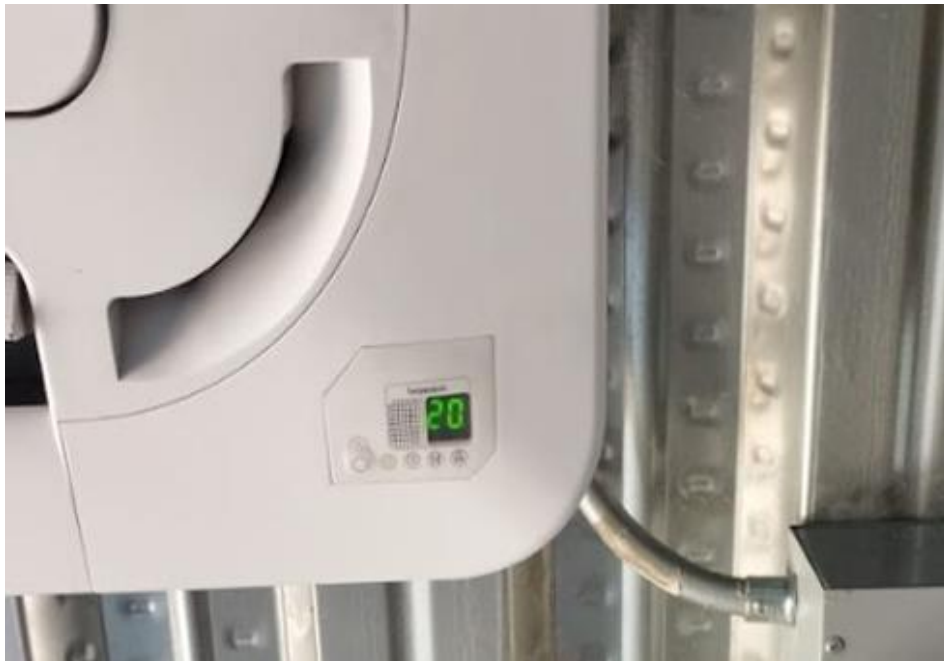
Figura 44 Fotografía de la unidad evaporadora. Se programó el AA a temperatura de 20 °C. Nota: Fotografía capturada por el autor (2025).
