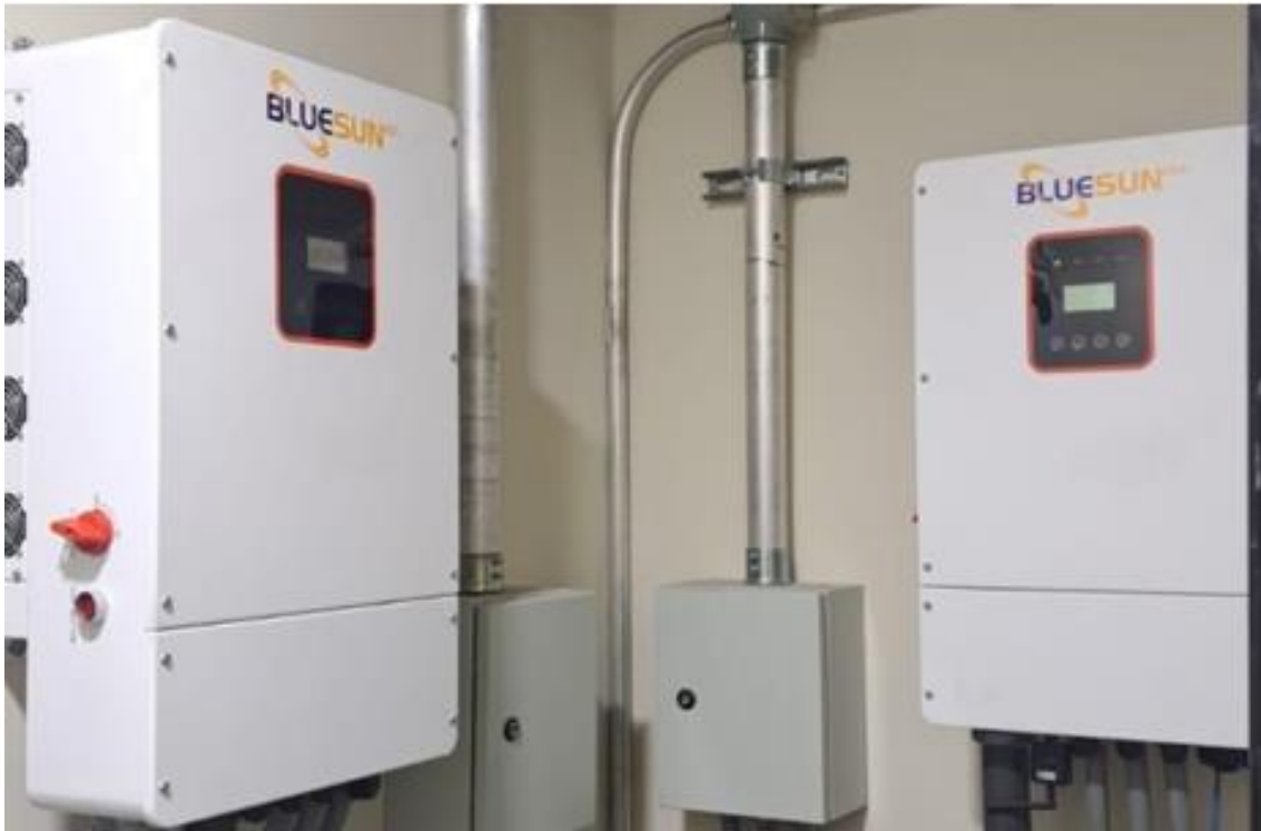
Figura 46 Inversores BlueSun. Nota: Fotografía capturada por el autor (2025).
