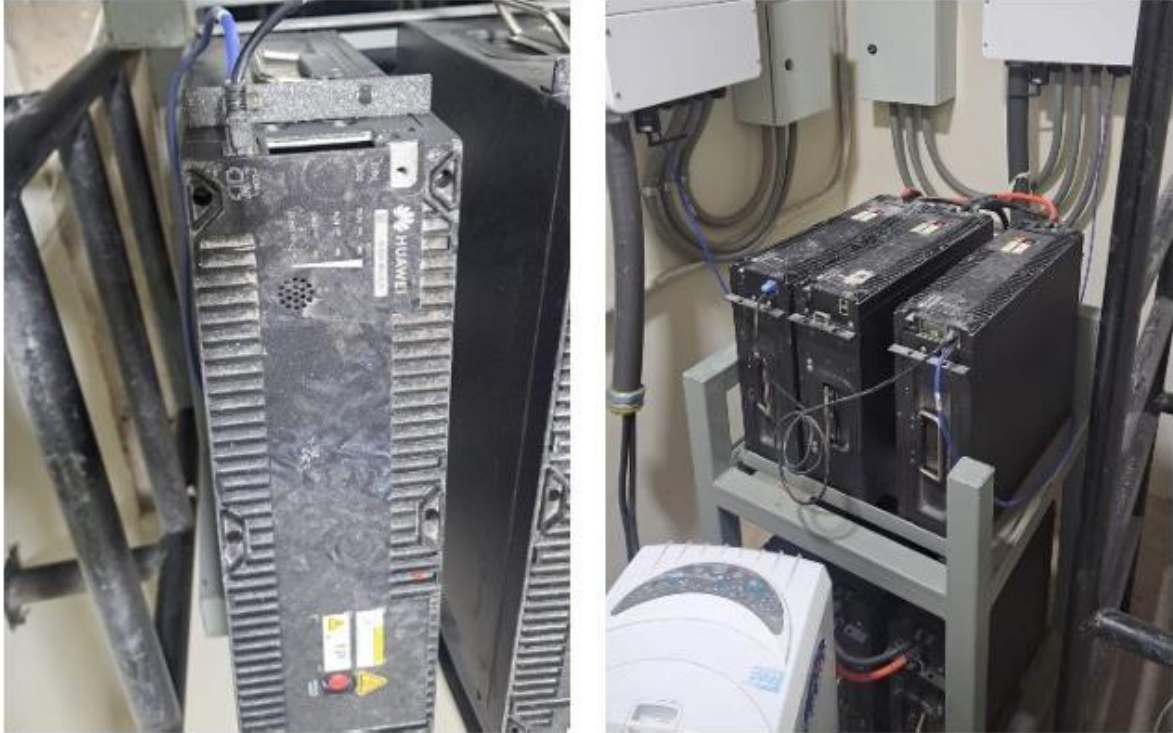
Figura 47 Banco de baterías. Nota: Fotografía capturada por el autor (2025).
