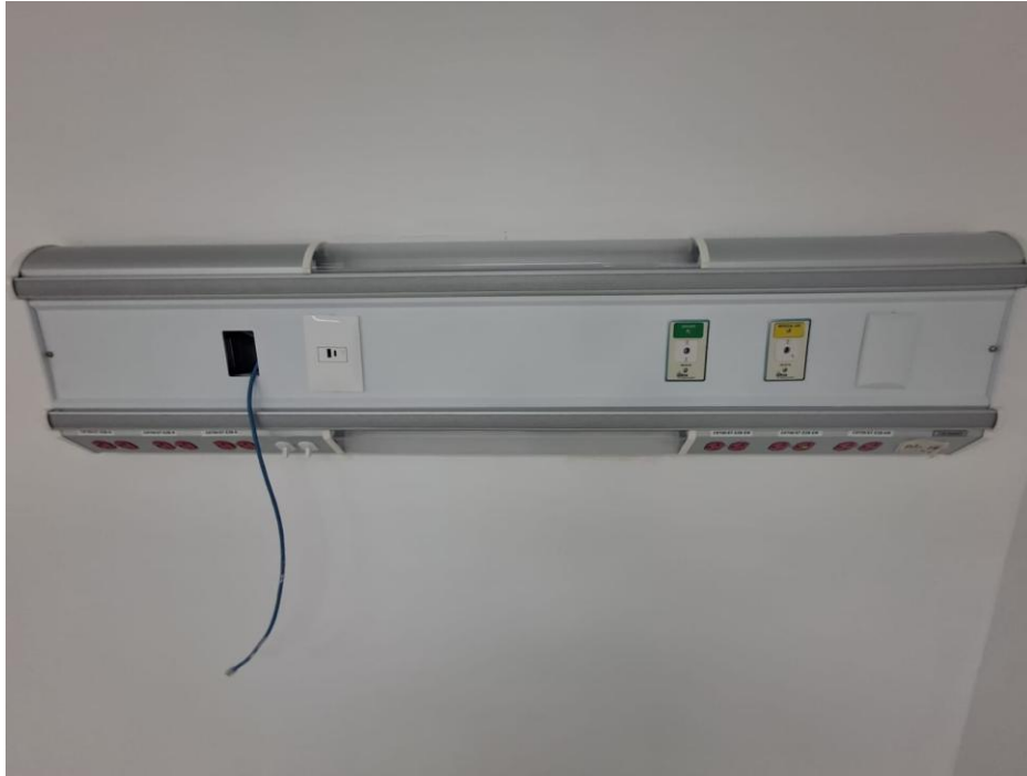
Figura 39 Cama en zona de cuidado general alimentada por dos circuitos derivados, sistema de emergencia y sistema normal
