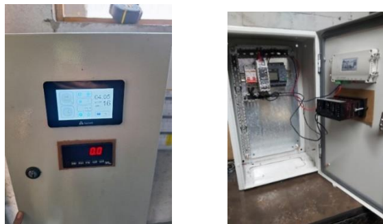
Ilustración 29. equipo para medición de consumo de energía. Fuente: elaboración propia.
