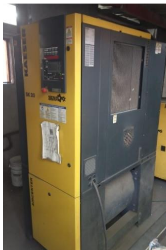
Ilustración 33. Compresor de aire en malas condiciones. Fuente: elaboración propia
