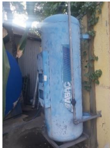
Ilustración 32. tanque de aire comprimido húmedo deteriorado. Fuente: elaboración propia
