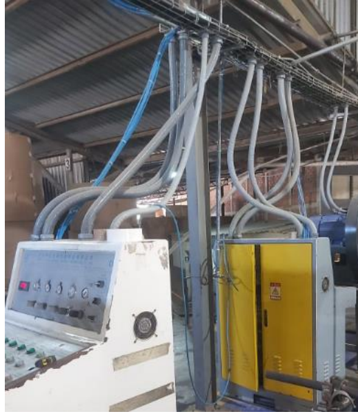
Ilustración 31. Acometidas en máquinas de producción
