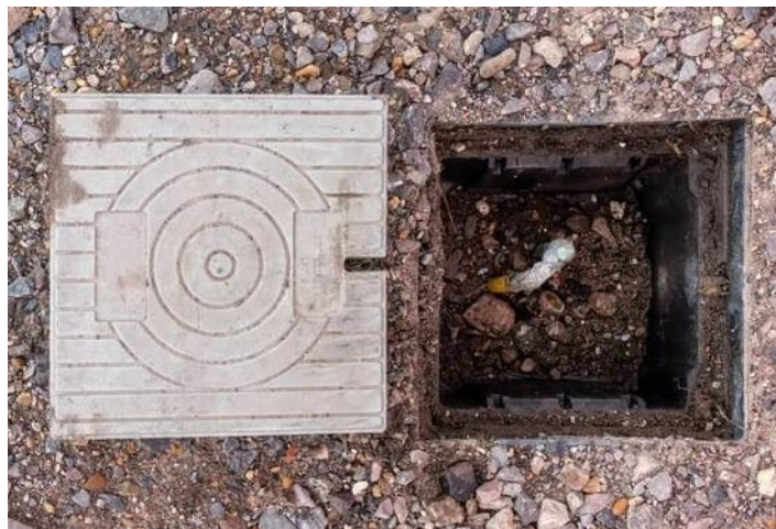
Figura 59. Pozo de registro para medición de la red de tierra de la Subestación
