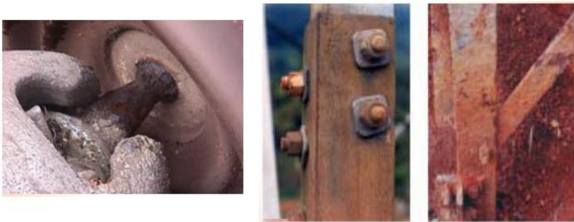
Figura 1. Ejemplos de Corrosión en Estructuras y elementos de una Subestación eléctrica [2]
