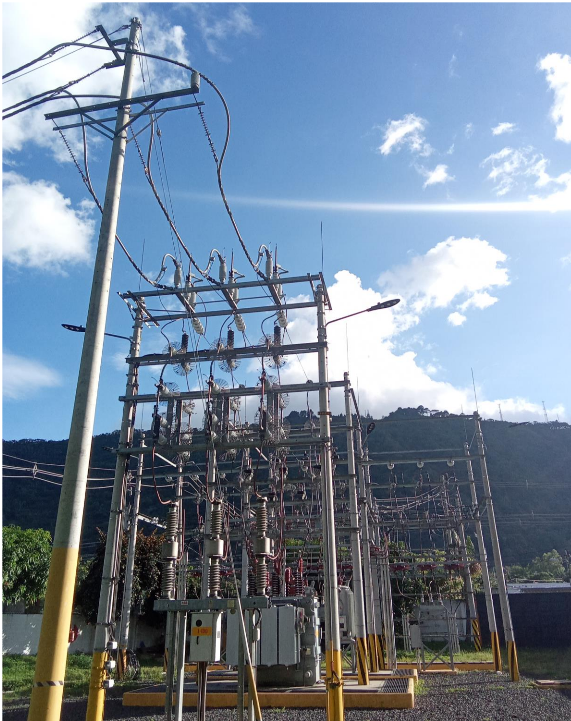
Figura 37. Subestación de Distribución San Marcos: capacidad 40MVA - 46/23 kV [Nota. Foto tomada en octubre 2023]
