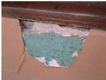
Img. 71 Daños en paredes
