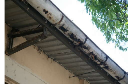
Img. 68 Corrosión por par galvánico
