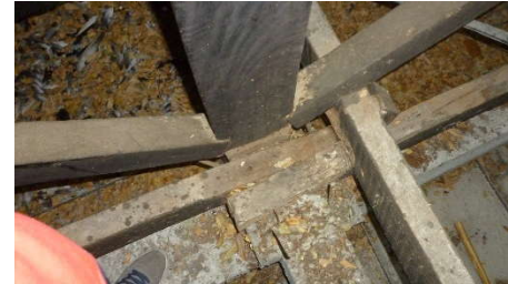
Img. 74 Daños en estructura de techo
