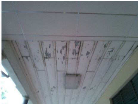
Img. 73 Daños en cielo falso
