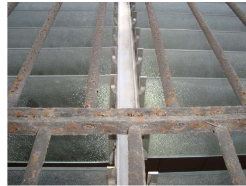
Img. 80 Corrosión en defensas
