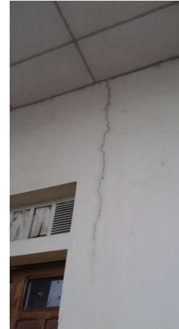
Img. 63 Grieta por carga
