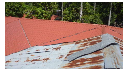
Img. 75 Daños en cubierta
