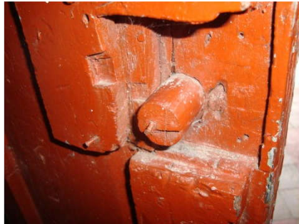
Img. 77 Falta de chapas en puertas
