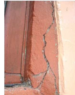
Img. 64 Grieta por dilatación
