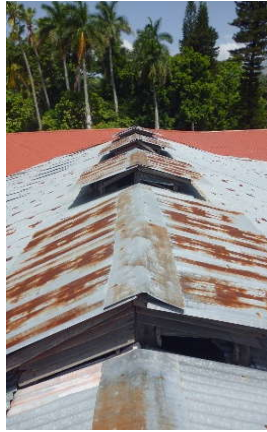
Img. 68 Corrosión por aireación diferencial
