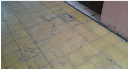
Img. 66 Erosión Mecánicas
