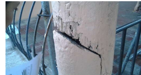
Img. 65 Fisura por soporte
