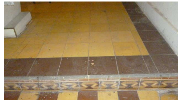
Img. 72 Daños en pisos
