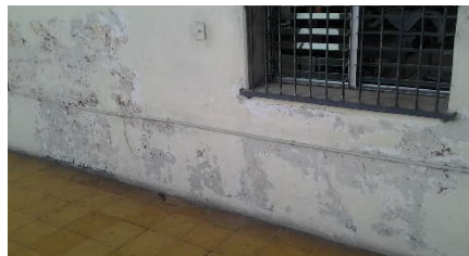
Img. 61 Humedad capilar
