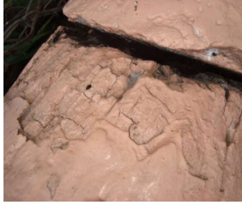
Img. 81 Putrefacción por la humedad
