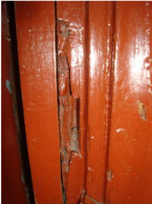
Img.76 Pudrición en madera de puertas
