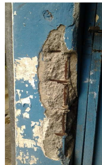
Img. 62 Erosión Atmosférica
