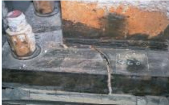
Figura III-1: Fractura en una placa base de columna de una estructura de pórtico arriostrado.
