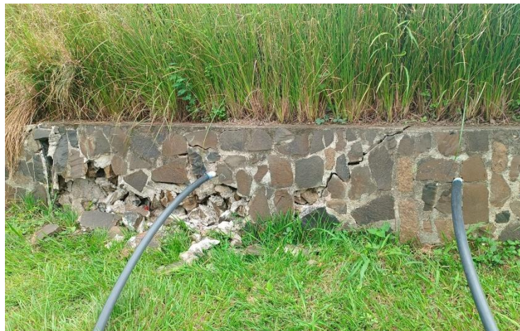
Figura 6-98. Se muestra destrucción de estructura de bloques de piedra irregulares, con una apariencia tosca y poco profesional Fuente: Elaboración propia
