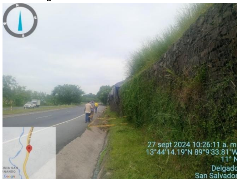
Figura 2-4. Deformación de muro de gavión sobre Carretera de Oro, kilómetro 18.5.
