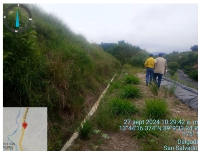
Figura 2-5. Condición actual de la ladera y canaleta de aguas lluvias en la parte alta del muro de gavión
