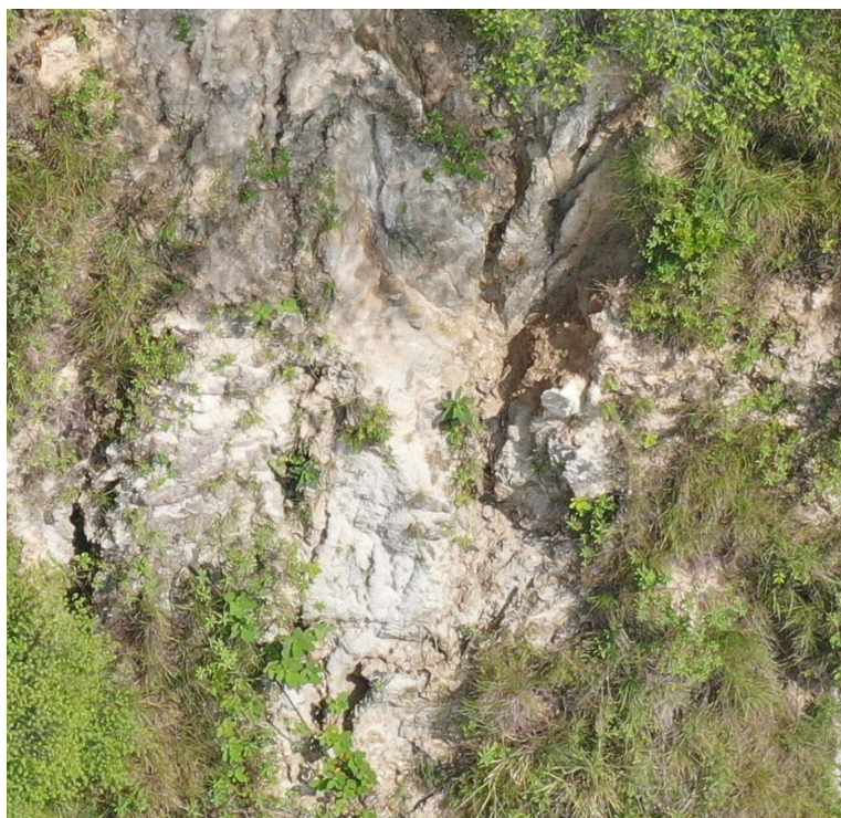
Figura 6-105. Fotografía aérea tomada por el dron mientras realizaba el plan de vuelo en el que se muestran fisuras de considerable tamaño y profundidad cercanas a la corona del talud.
