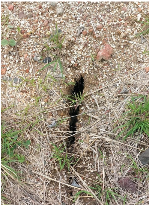
Figura 6-106. Se muestra una fisura considerable encontrada en la corona del muro de gavión.
