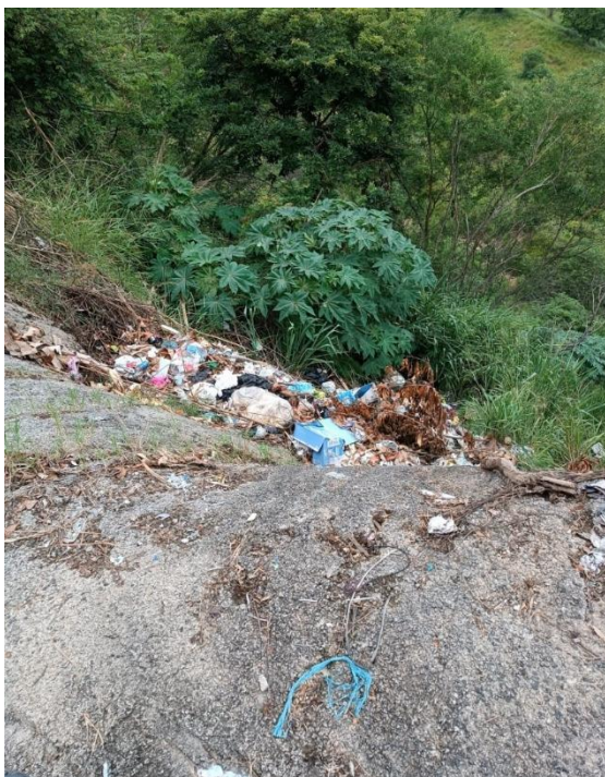
Figura 6-104. Se muestra parte de la corona del talud con presencia de desechos solidos. Fuente: Elaboración propia
