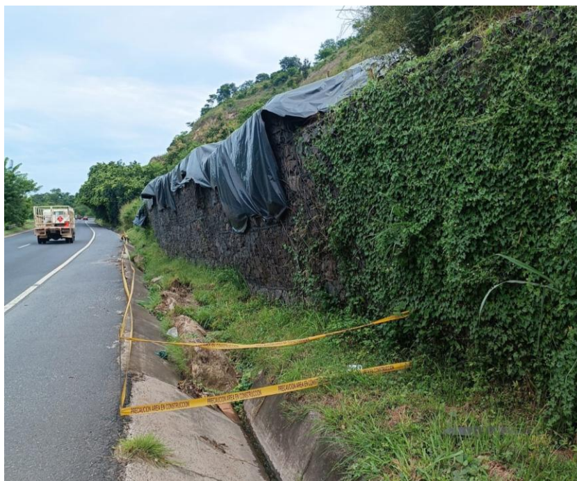
Figura 6-96: Deformación visible del muro de gavión a la orilla de la carretera de Oro.
