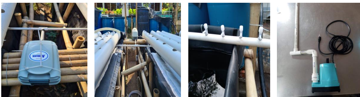
Figura 11. Sistema de aireación.
