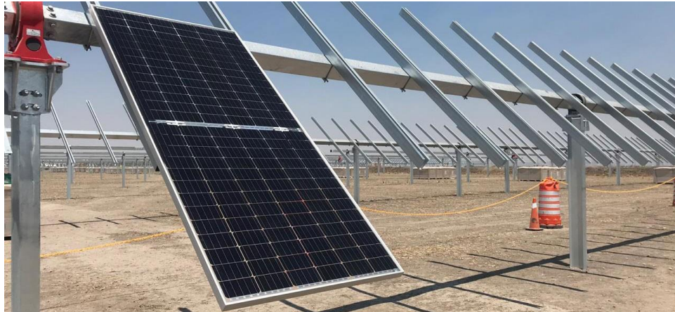
Figura 62. Estructura de soporte para paneles bifaciales.
