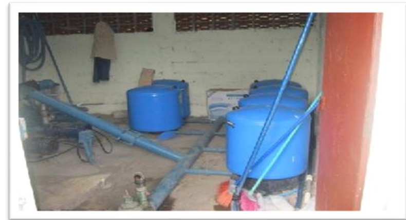
Fotografía 17. Casa de Maquinas, Manantial, Nacimiento 1 (Principal) donde se Ubica la Cueva. Recuperado de: Consultoría Hidráulica del Parque Acuático "Altos de La Cueva" p. 11)
