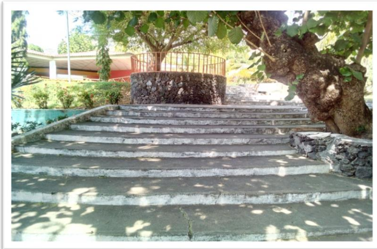
Fotografía 73. Gradas de acceso a piscinas, actualmente no cuentan con rampas para discapacitados. Fuente: fotografías recopiladas durante visitas técnicas.
