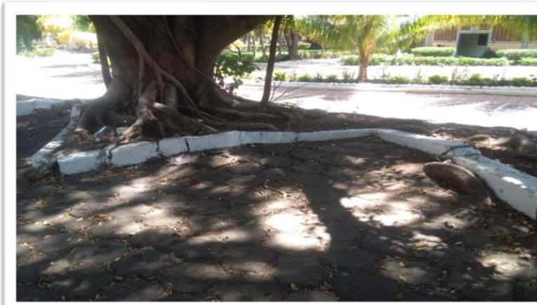
Fotografía 64. Estacionamientos en mal estado. Fuente: fotografías recopiladas durante visitas técnicas.
