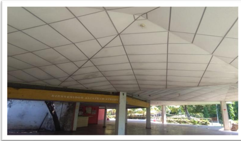
Fotografía 67. Cielo falso de cafetería principal en mal estado. Fuente: fotografías recopiladas durante visitas técnicas.
