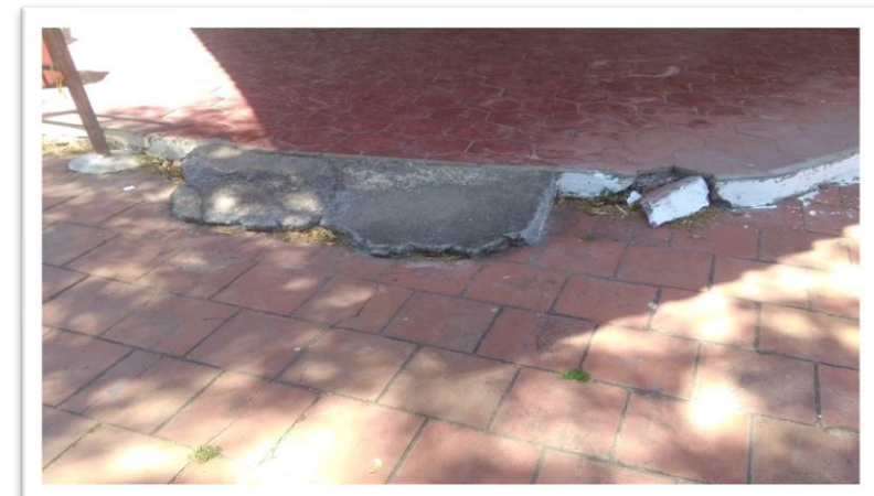
Fotografía 66. Piso interno de cafetería principal en mal estado. Fuente: fotografías recopiladas durante visitas técnicas.
