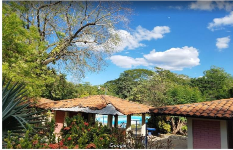
Fotografía 58. Kioscos-vestidores, en la imagen se aprecia el techo de tejas y algunas tejas faltantes. Recuperado de: https://www.google.com/maps/place/Turicentro+Altos+de+La+Cueva
