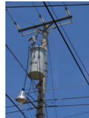
Transformador y luminaria pública
