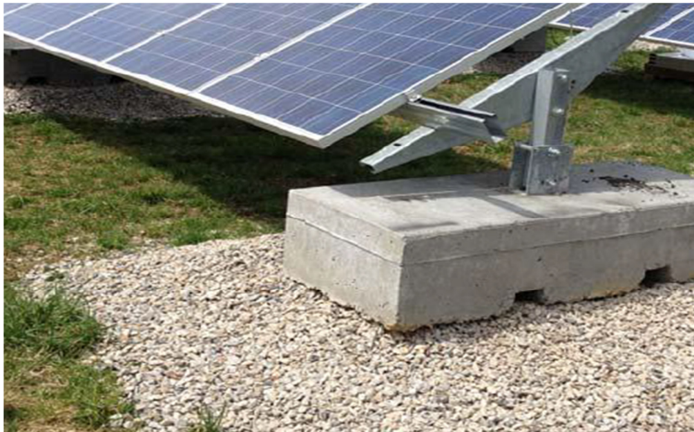
Figura 7.18: Módulos fotovoltaicos montados en estructura metálica.
