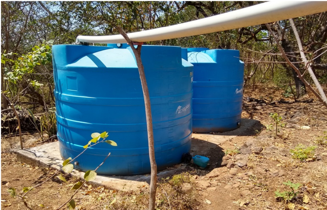
Figura 9.5: Tanques cosechadores de agua lluvia de 6000 litros cada uno.
