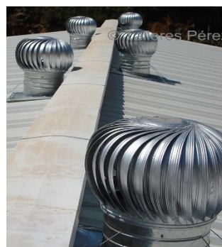
Anexo 4 : Extractores de aire
