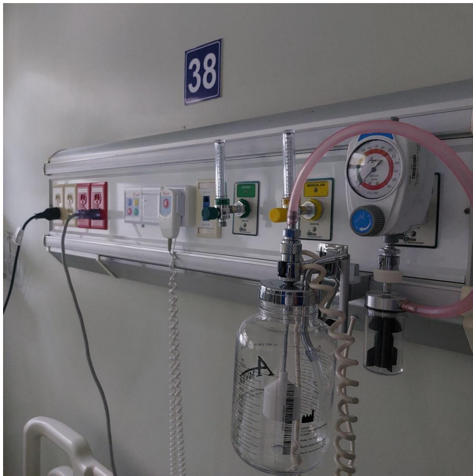
Ilustración 47 Unidad de Cabecera unidad de recuperación ISSS SM
