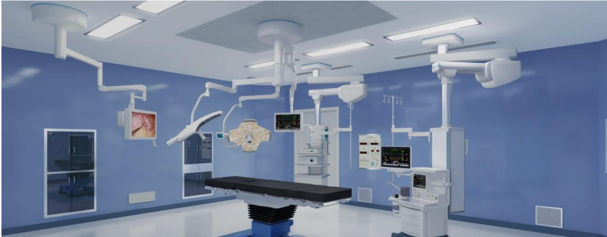
Ilustración 63 Quirófano iluminado correctamente.
