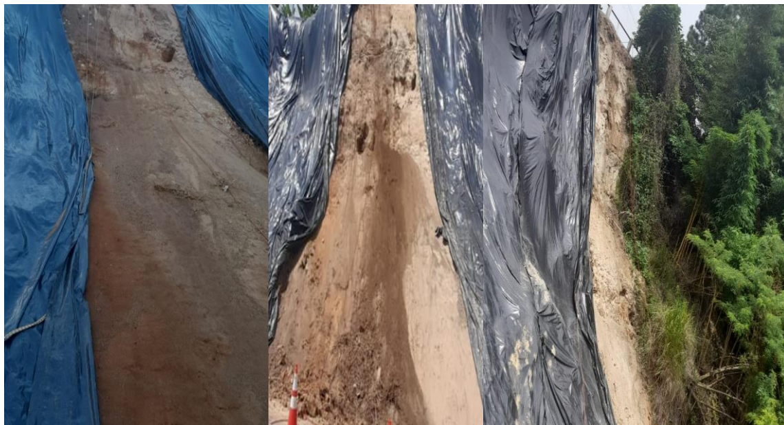
Ilustración 9. Fallas comunes de tierra blanca observadas en la Residencial: a) y b) Cárcavas o zanjas provocadas por la erosión, c) Exfoliación o caída por capas del material debido al intemperismo.
