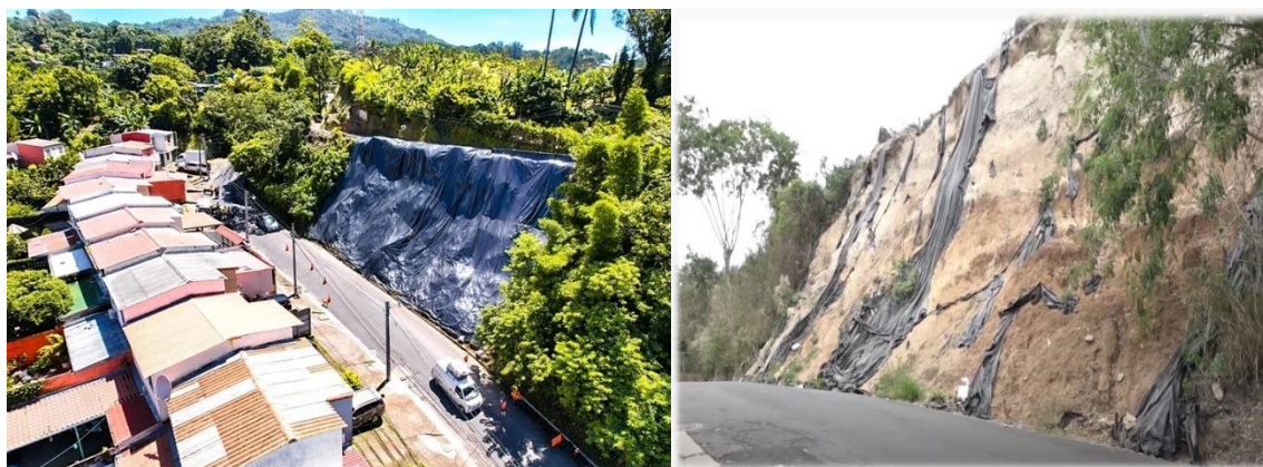
Ilustración 8. A) Viviendas que se ubican al pie del talud y que reciben todo el material que se desprende desde el talud, corriendo el riesgo de ser soterradas. B) Pérdida de una porción de la vivienda mostrada debido a un deslizamiento ocurrido durante
