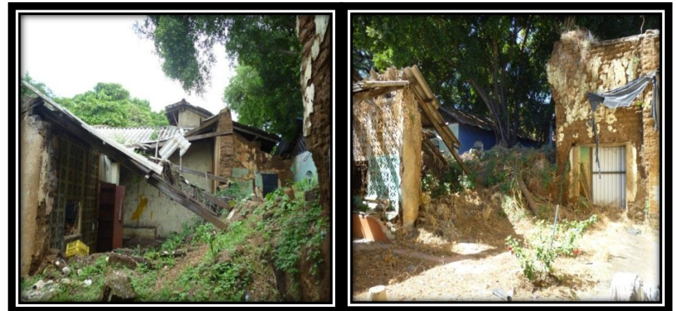
Fotografía N° 18 Daños Ocasionados por Terremotos en el Dolores Souza
