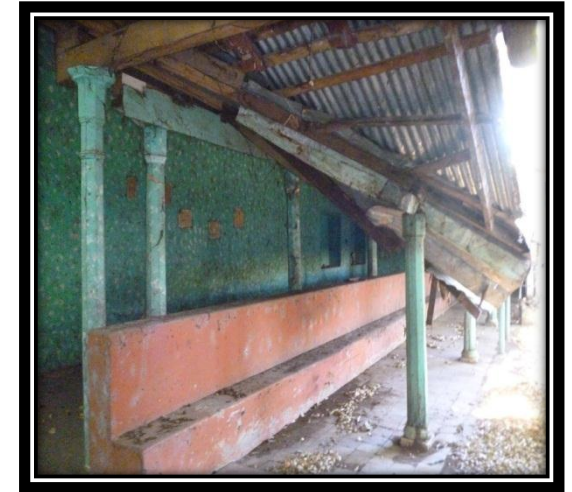
Fotografía N° 3 Daños a estructura, ocasionados por los Terremotos.
