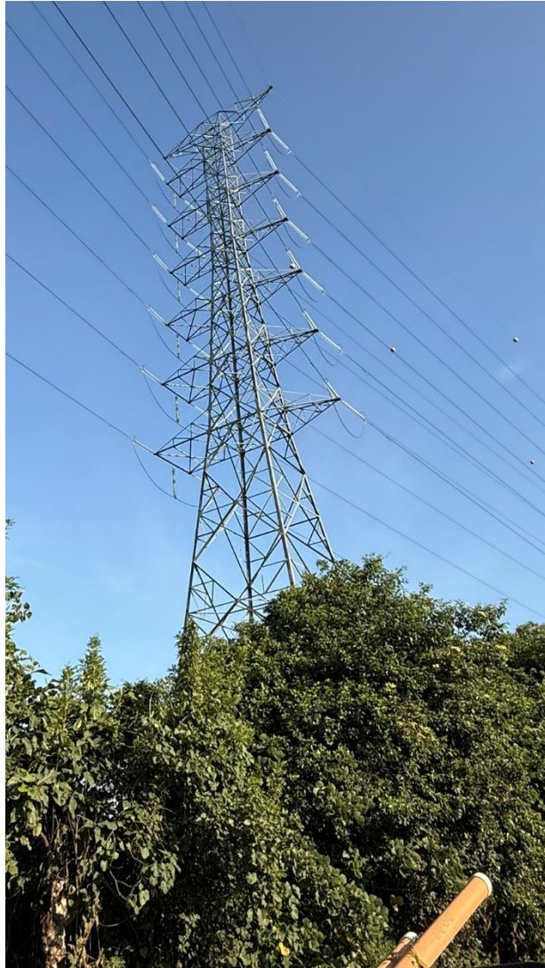
Figura 2.8 - Estructura Autosoportada del Sistema de Transmisión de El Salvador, 230kV, 4 circuitos. Ubicada en Nejapa, San Salvador Oeste.
