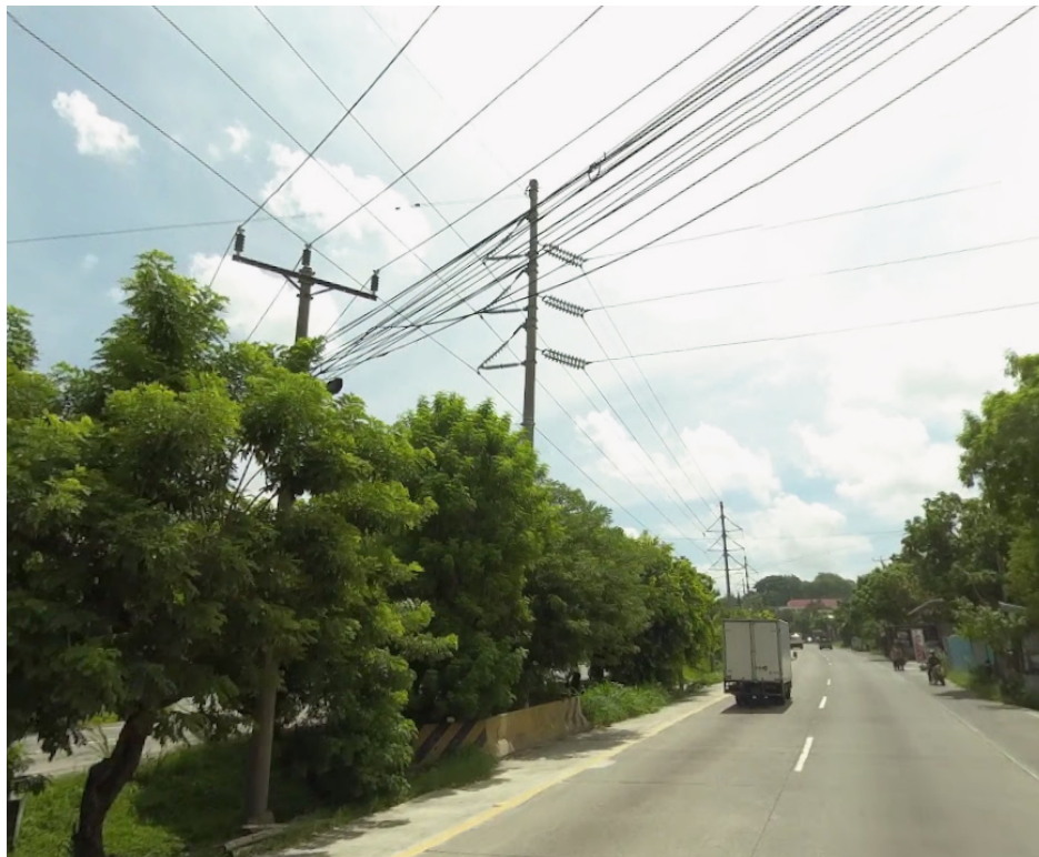
Figura 2.6 - Tramo de Línea a 115kV con Postes Tronconicos. Cercanías de Subestación San Bartolo ETESAL, Ilopango, San Salvador Este
