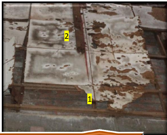
Fig.36: Panel de Aislamiento
