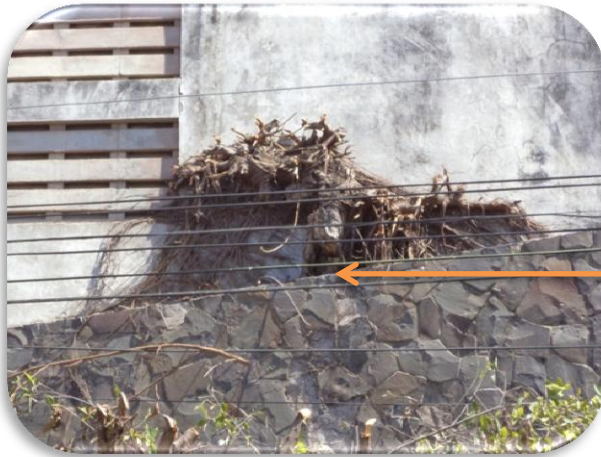
Daños Causados por raíces en Pared costado sur
