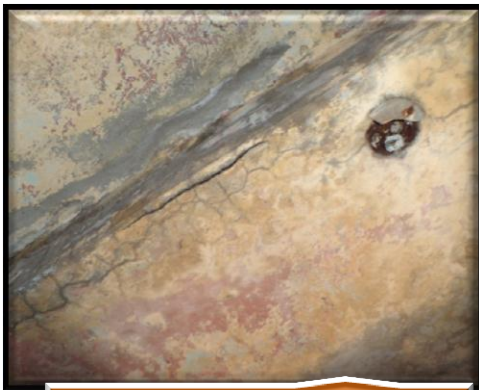
Fig. 54: Losa con Macrofisuras
