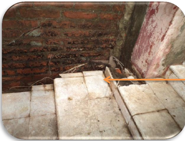
Daños Causados por raíces en escaleras (Mezzanine)
