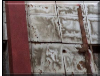
Hongo en estructura de aislamiento acústico
