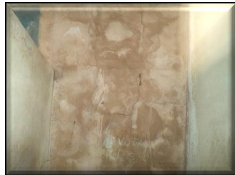
Hongo en estructura de concreto
