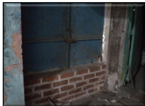
Salida de emergencia
