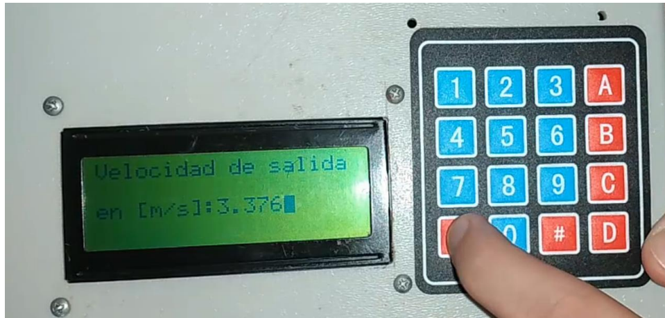
Figura 42 Pantalla para parametrizar la velocidad de flujo de aire del conducto de ventilación.
