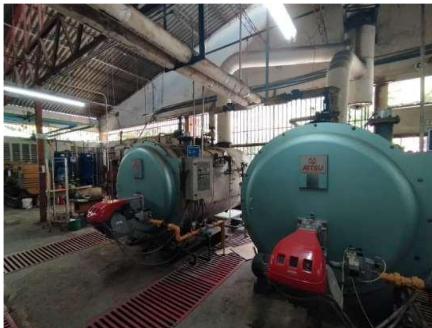
Figura 3.2: Equipos de calderas, departamento de mantenimiento [28]
