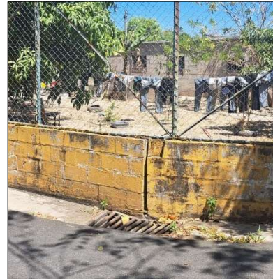
Foto N°34: Caja de Aguas Iluvias
