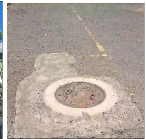
Foto N°37: Pozo de Aguas negras BIFA
