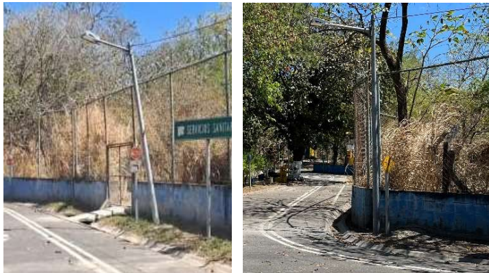
Foto N°32 y N° 33: Luminarias.
