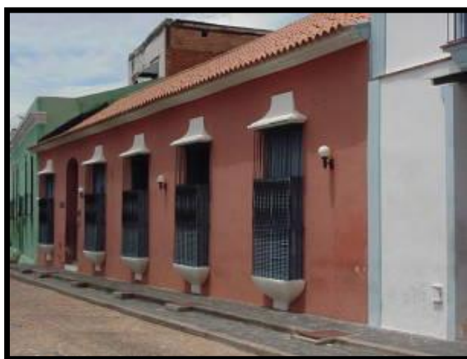
Ilustración 82 HERRERIA EN VENTANAS
