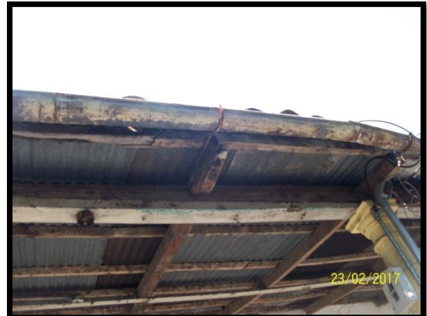
Ilustración 23 FALTA DE INFRAESTRUCTURA HIDRÁULICA EN TECHO
