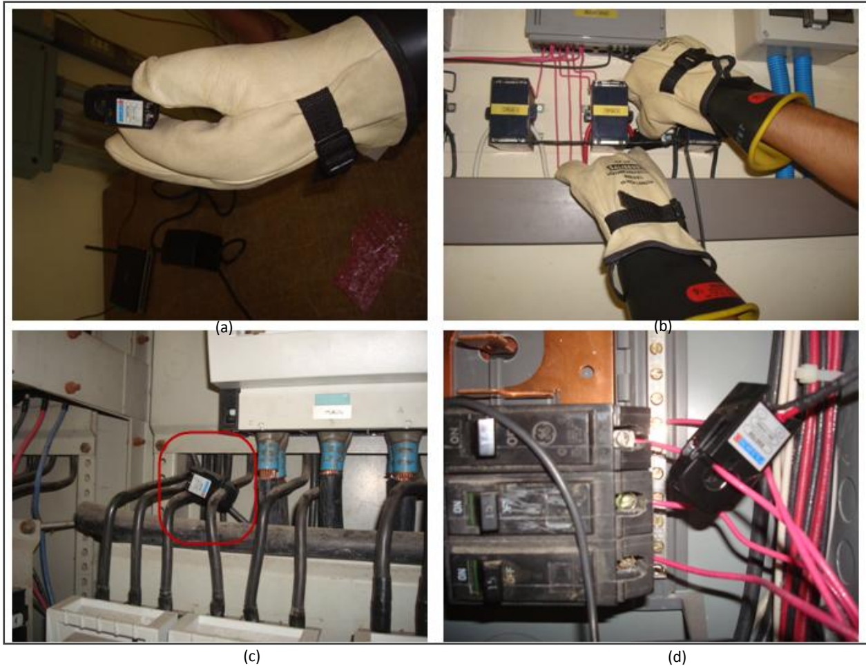
Figura D.3 : (a) Pinza de corriente; (b) instalación de la Pinza de corriente; (c) Instalación de la pinza en el tablero eléctrico principal de la EIE; (d) Instalación de la pinza de corriente en una fase del tablero.
