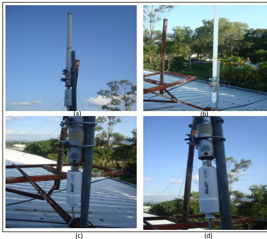
Figura D.1 : (a); (b); (c) y (d) Muestran la instalación del router BULLET 2 en modo AP en el techo de la EIE.
