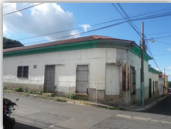
Imagen 18. Inmueble en Deterioro
