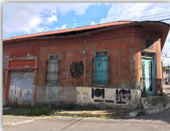
Imagen 20. Inmueble en Deterioro
