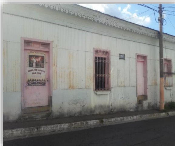
Imagen 17. Inmueble en Deterioro
