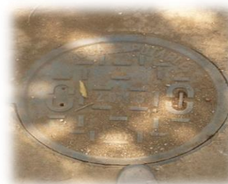
FOTO 15: POZO AGUA POTABLE. Fuente: Levantamiento Fotográfico marzo 2018
