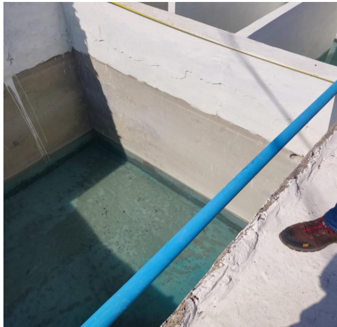
Anexo 2: Observación de del agua tratada clarificada.
