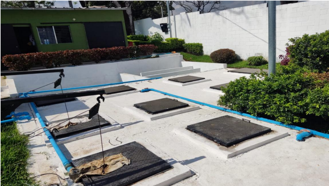
Figura 4: Planta de tratamiento de aguas residuales de reactor biológico.
