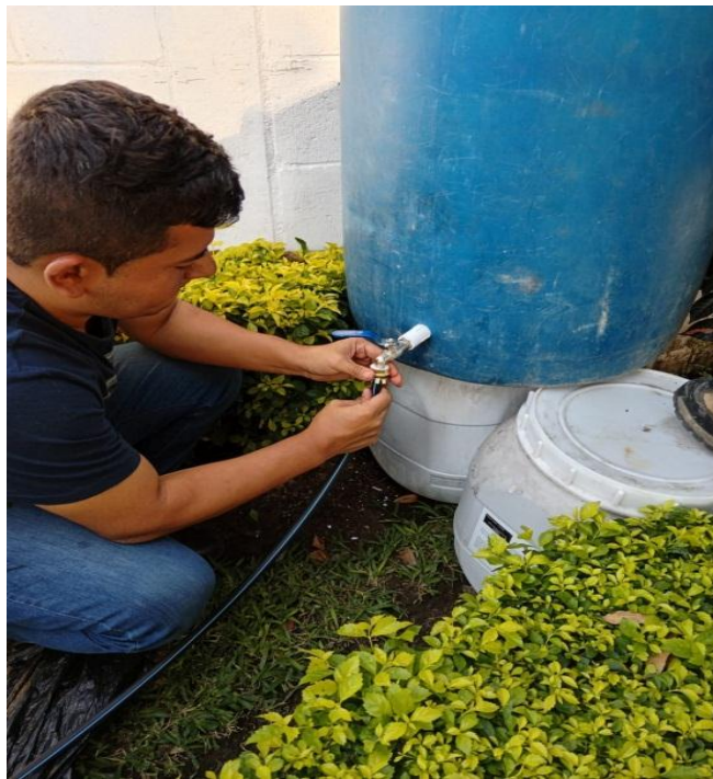
Anexo 6: Colocación del barril de 55 gal.
