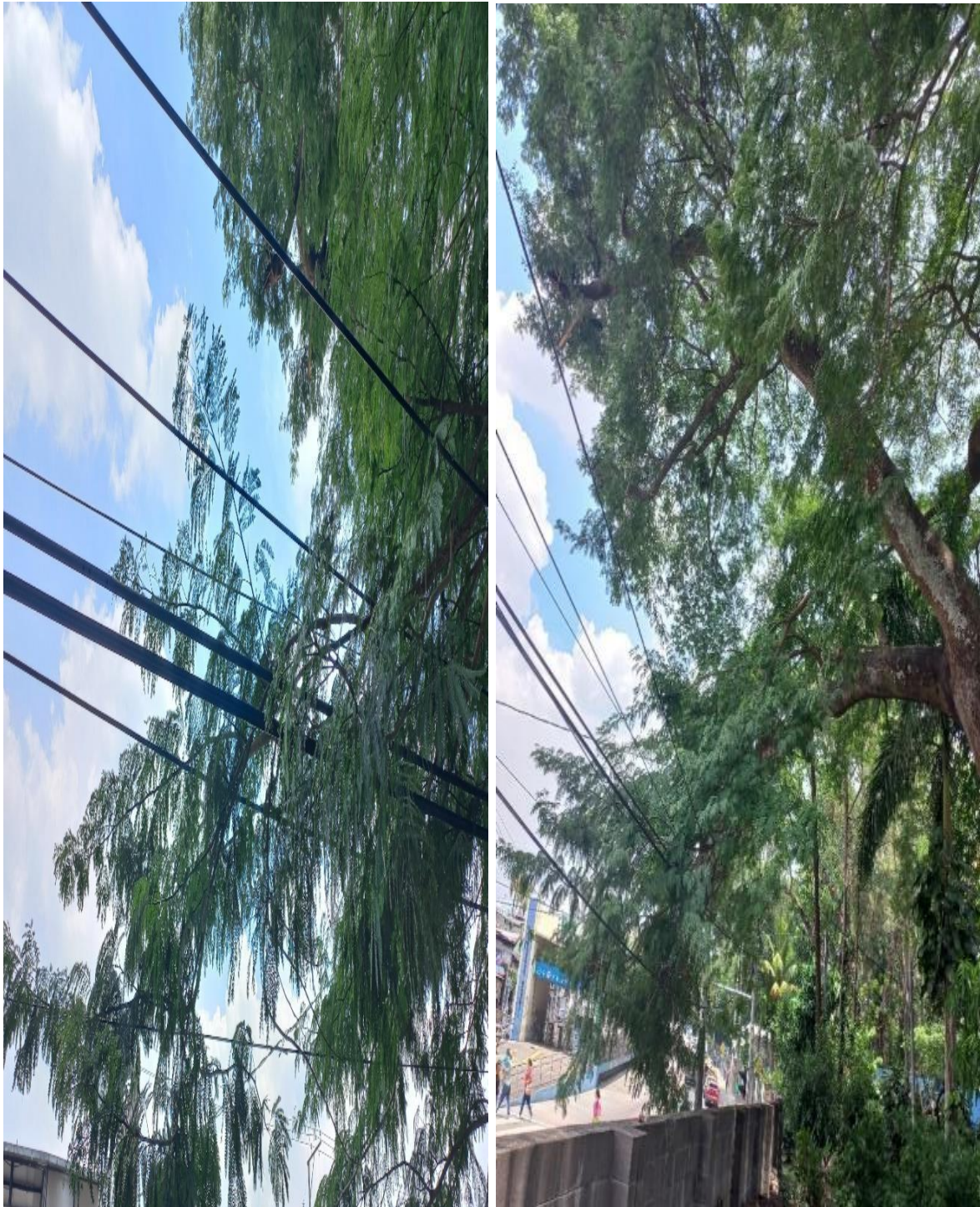
Figura A-4. Arboles del parque infantil que presentan conflictos con el tendido eléctrico.
