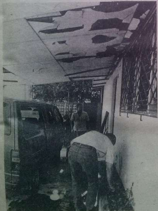
ATENTADO DINAMITERO.— La residencia de una misionera evangélica neo-zelandesa fue objeto anoche de un atentado en el que se produjeron daños materiales. La vivienda está ubicada en la Col. Yumuri al Poniente de la capital.
