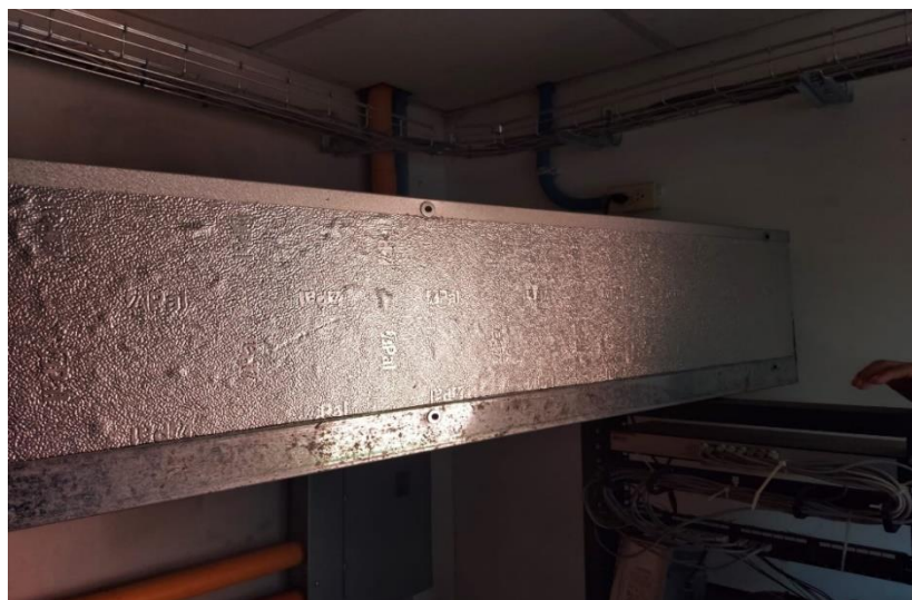
Figura 3.13 Canalización de aire caliente hacia salida externa - Visita técnica
