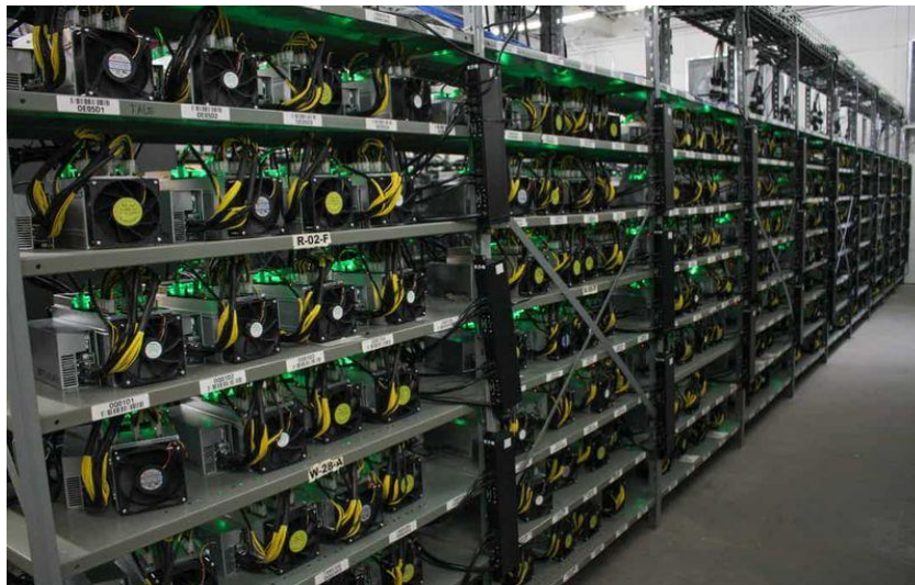
Figura 3.12 Montaje en infraestructura por niveles con equipos ASIC
