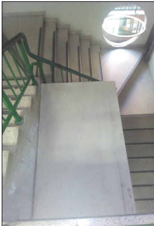
Gradas de Emergencia a Maternidad: tiene un peldaño transversal que invade la zona de descanso.
