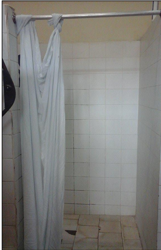
Ducha de cirugía hombres con piso dañado.
