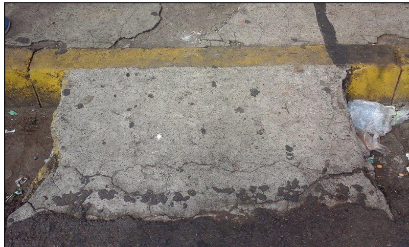
Rampa Entrada Visita no cumple con las medidas adecuadas para ser utilizada.
