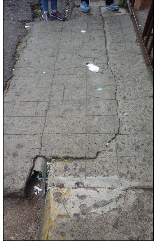
Rampa Entrada Principal no posee una superficie firme y sin resaltos.
