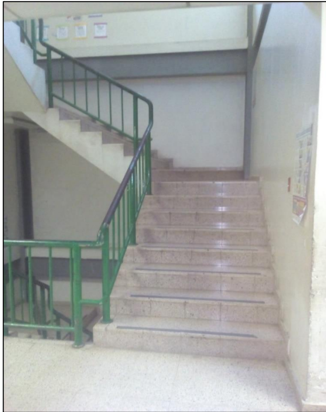
Pasamanos de emergencia a Administración no se encuentran a ambos lados y no poseen el diámetro adecuado.
