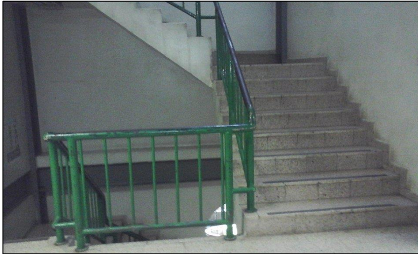
Gradas de Emergencia a Maternidad: no posee pisos antideslizantes.
