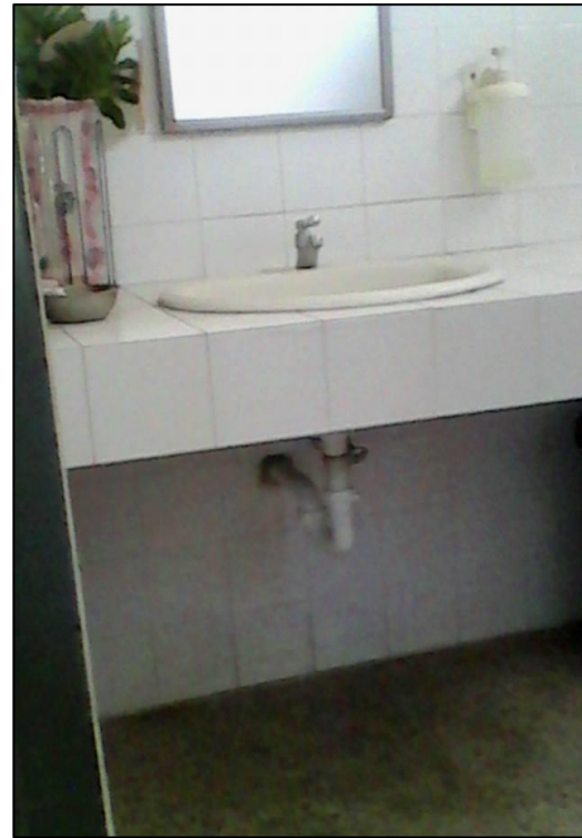
Lavamanos del área de Ginecología sin pedestal, pero no cuenta con grifería de tipo palanca
