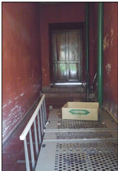
Entrada Visitas. Posee obstáculos que no permite la libre circulación de las personas.
