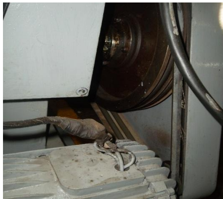
Figura #74: Motor eléctrico.
