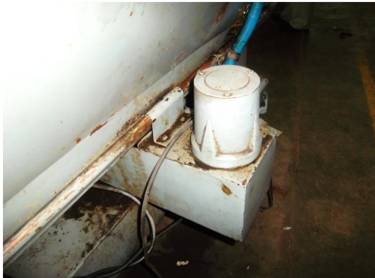
Figura #60: Bomba de refrigeración.
