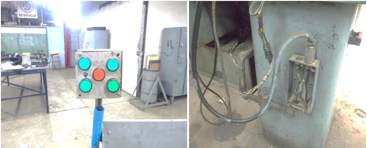
Figura #57: Cables eléctricos.
