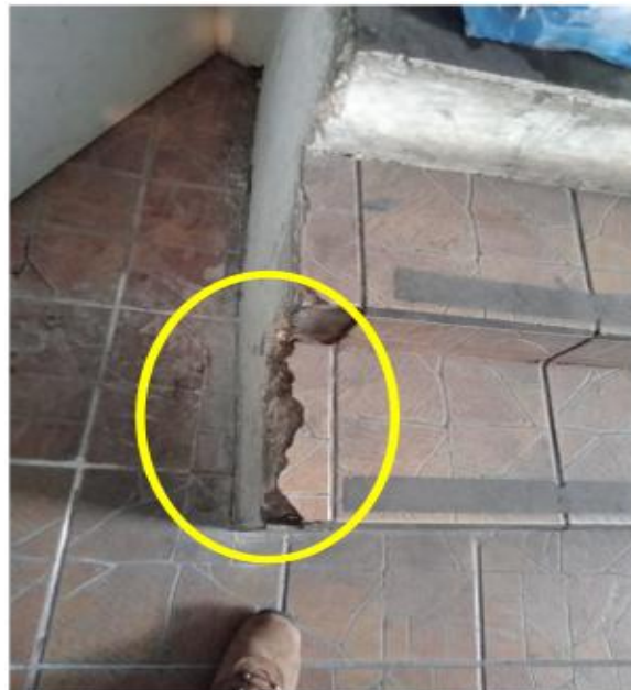
Imagen 11: Lozas en mal estado, pero con lija.
