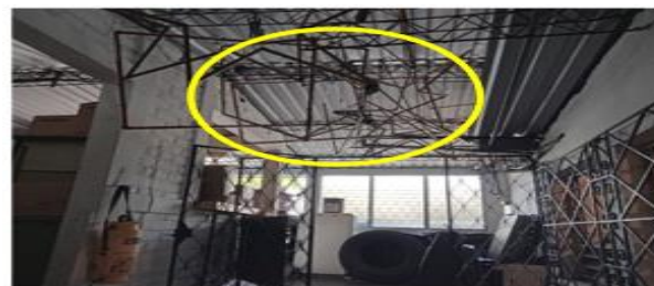
Imagen 13: Materiales peligrosos (y probablemente inservibles) pendiendo del techo.
