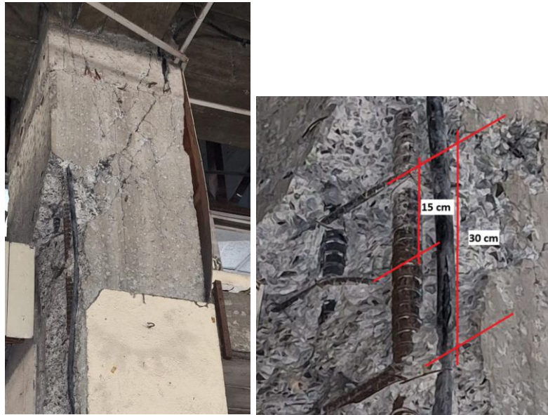
Imagen 4. Daño por tensión diagonal fuente: propia
