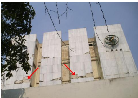
Imagen 21. Recubrimiento de mármol año 2008 fuente: tesis Evaluación de daños típicos de edificaciones en el área metropolitana de san salvador ante los sismos ocurridos en 1986 y 2001.
