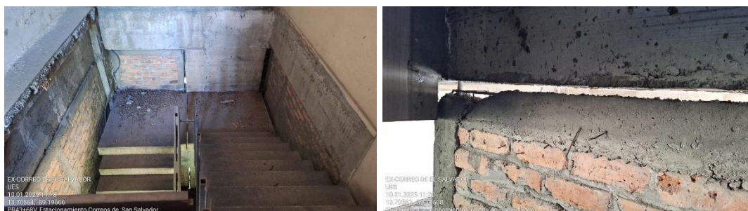
Imagen 49. Cuerpo de escaleras vinculados directamente a la estructura principal y cerramientos de mampostería con juntas de 4 cm. fuente: propia
