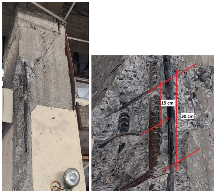
Imagen 46. El daño más severo del edificio se localiza en una de las columnas del primer nivel, la cual presenta una falla por cortante. fuente: propia
